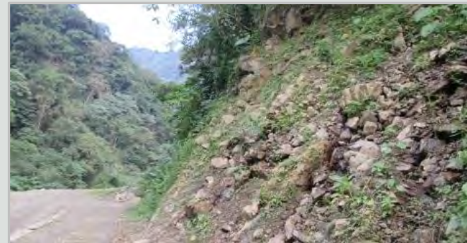
觀音瀑布山區邊坡現況
