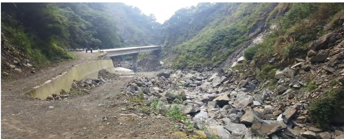
圖 5.1-2 觀音瀑布區聯外道路溪床現況
