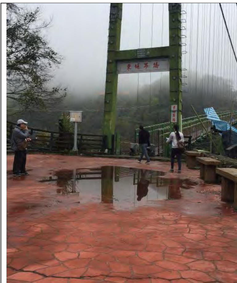
鋪面老舊積水
