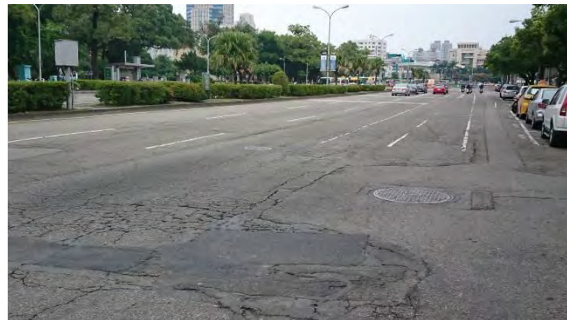
既有道路孔蓋繁多
