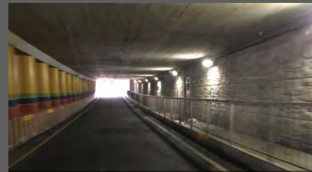
連通道寬度不足
