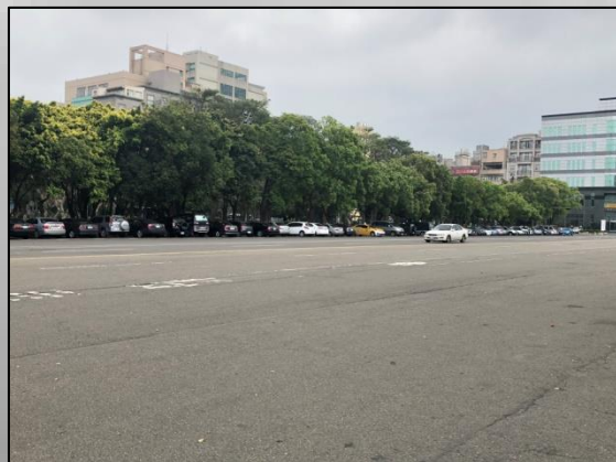
路面龜裂不平
