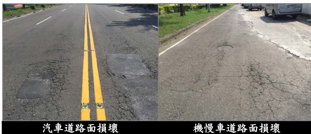
圖 43 車道路面損壞現況照片
