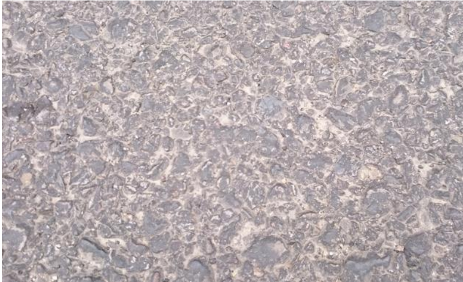
圖 7.1 多孔隙瀝青混凝土粉塵阻塞
