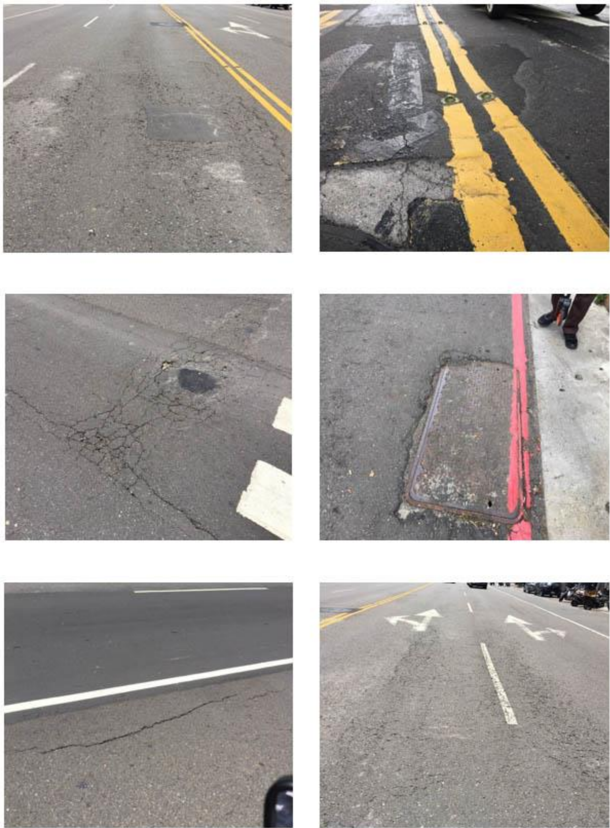
圖 6 九如二路市區道路柔性鋪面損壞調查照片
