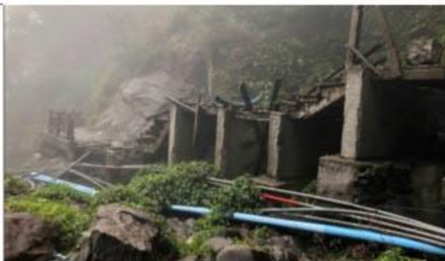
J. 彩虹瀑布木棧道及觀水平台破損造成通行安全
