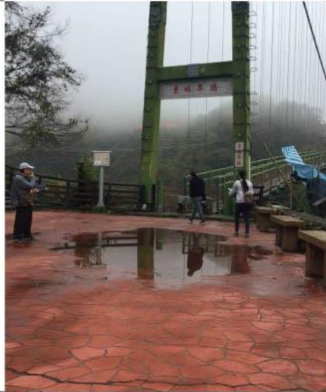
鋪面老舊積水
